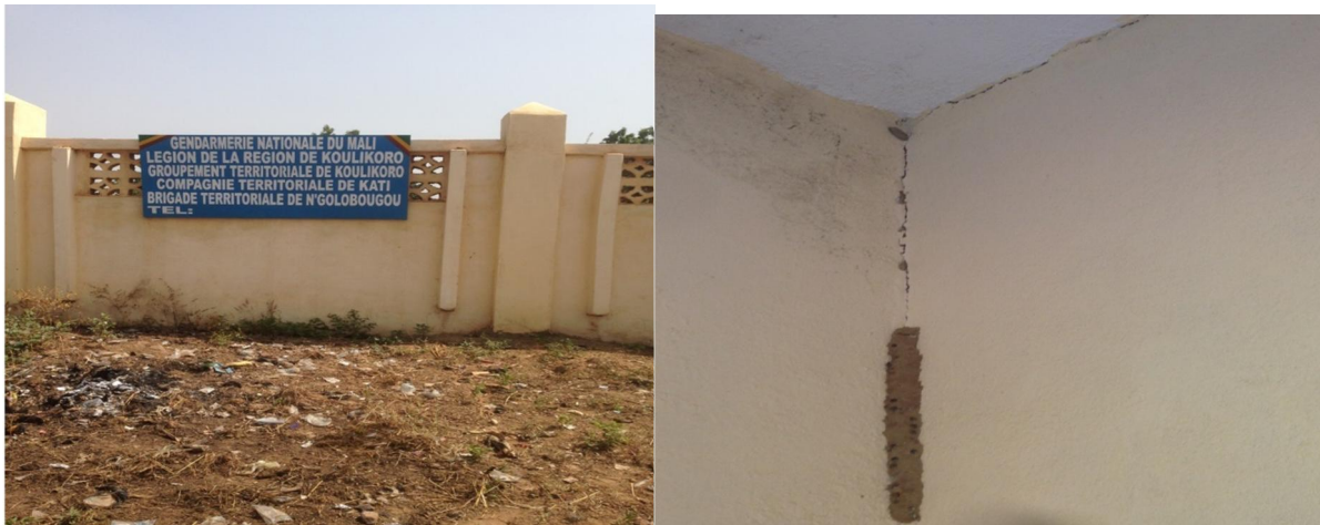
Façade de la nouvelle Brigade Territoriale de Kabala avec Fissure
